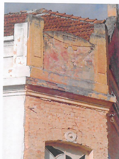
Foto 04: Trinca na esquina.
