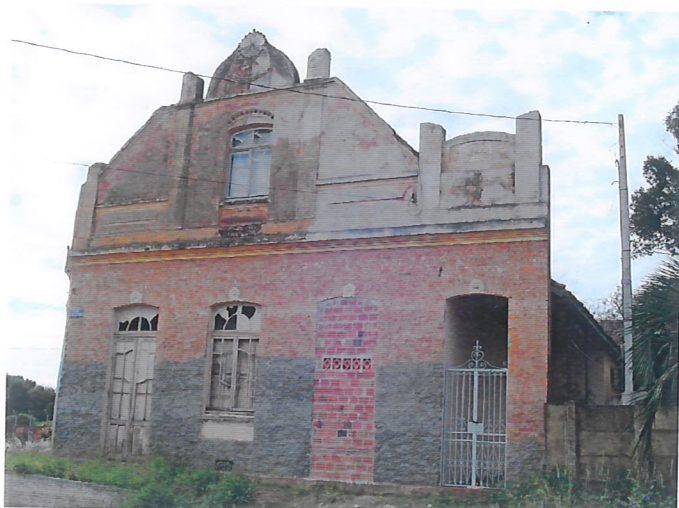
Foto 03: Vão da porta fechado e reboco descascado.
